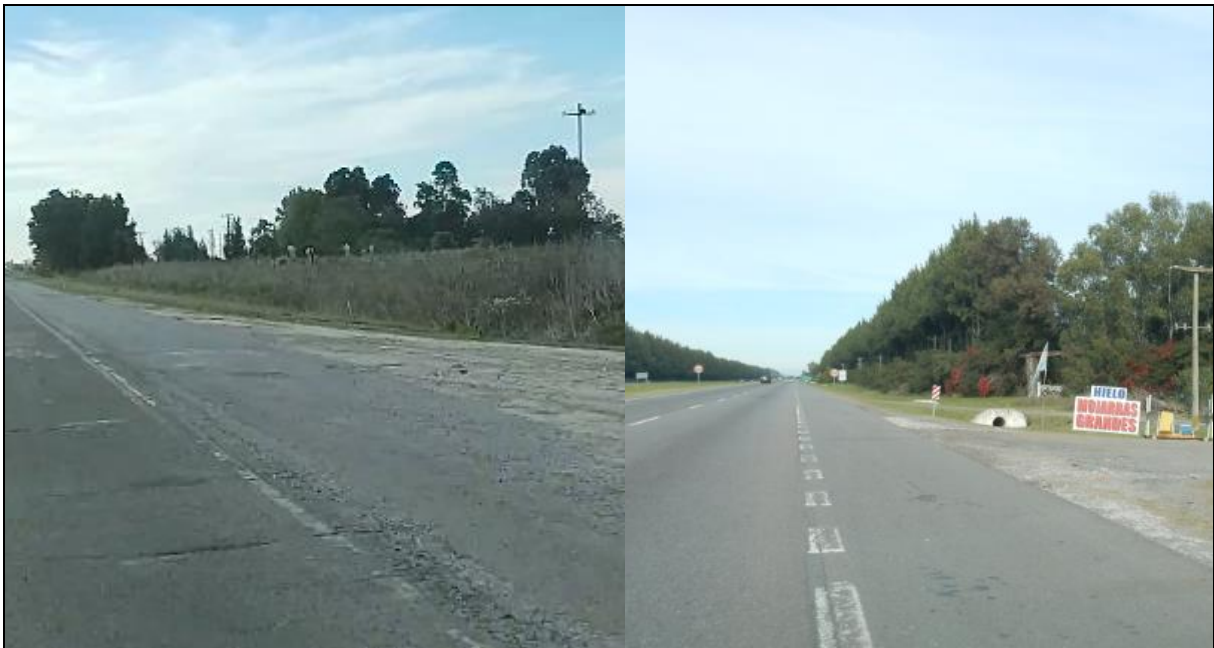
Foto 237, Foto 238, Foto 239 y Foto 240. Estado de señalización horizontal actual
